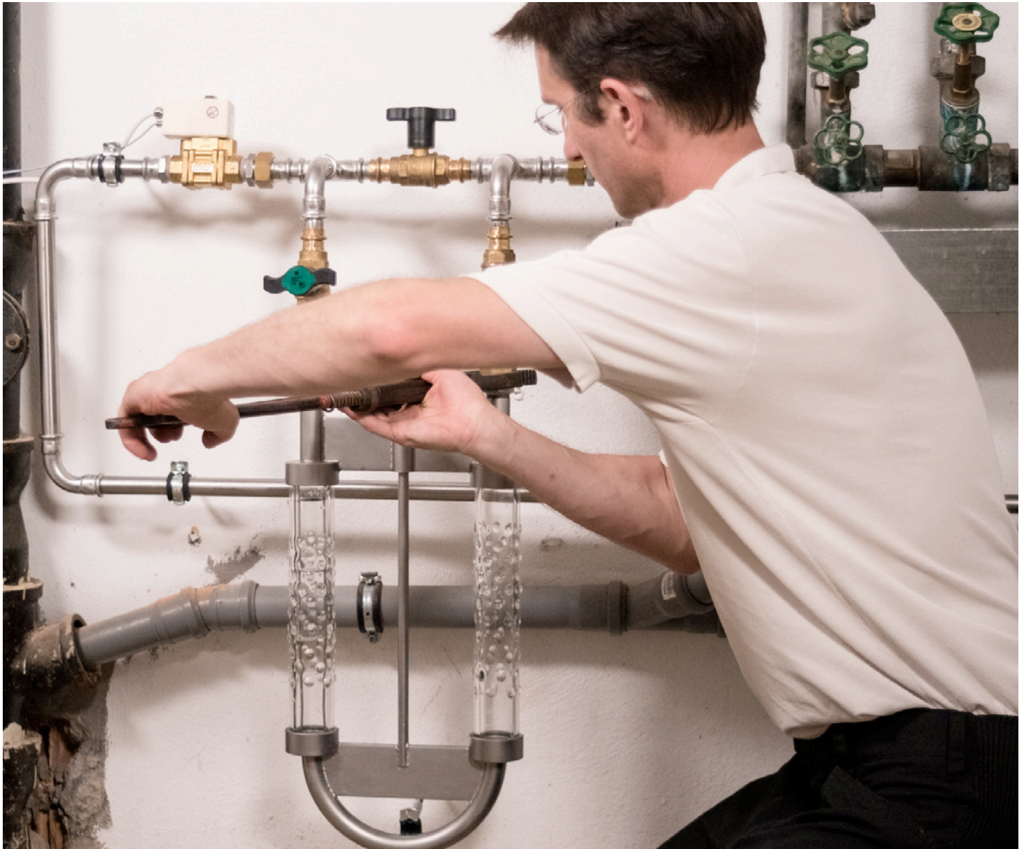
Anschluss des Aqua Relux Systems an die Hauptwasserleitung zur Vitalisierung des gesamten Brauch- und Trinkwassers im Haushalt.
